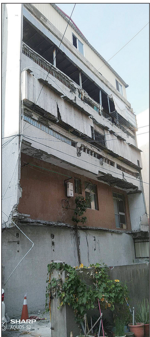
有住家二樓陽台整個掉落。
