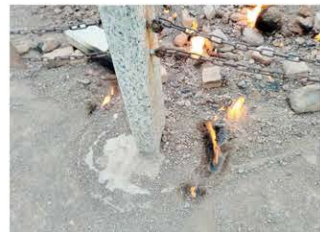
6. 火勢依舊從施工後較鬆軟的水泥樁基座冒出。
