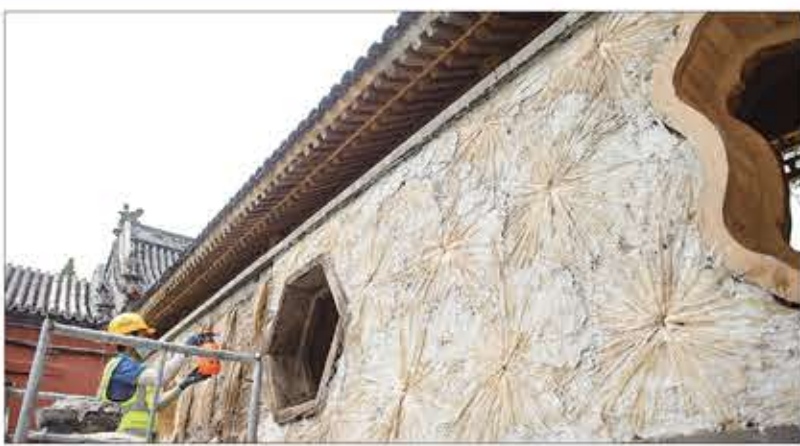
北京萬壽寺歷經五年修繕再度對公眾開放；工人使用「釘麻揪」傳統工藝修繕萬壽寺內院牆。
